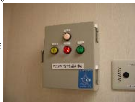
オゾンガス発生装置監視盤
