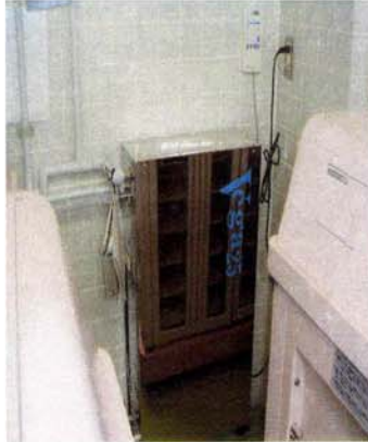
関西老人福祉センター 厨房 (オゾン水・エア)
