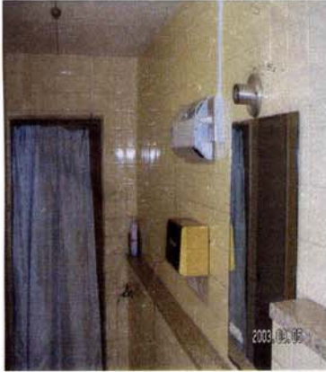
東京都老人ホーム トイレ 16箇所
