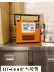
BT-088室内設置
